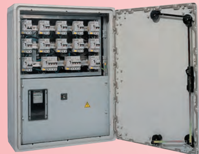
Inner Door / Dead-front Ready
